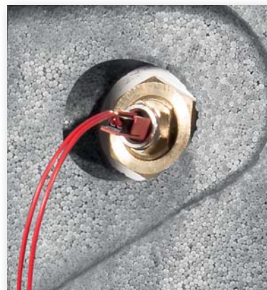
Sonda sanitaria nel bollitore e isolamento in polistirolo autoestinguente
